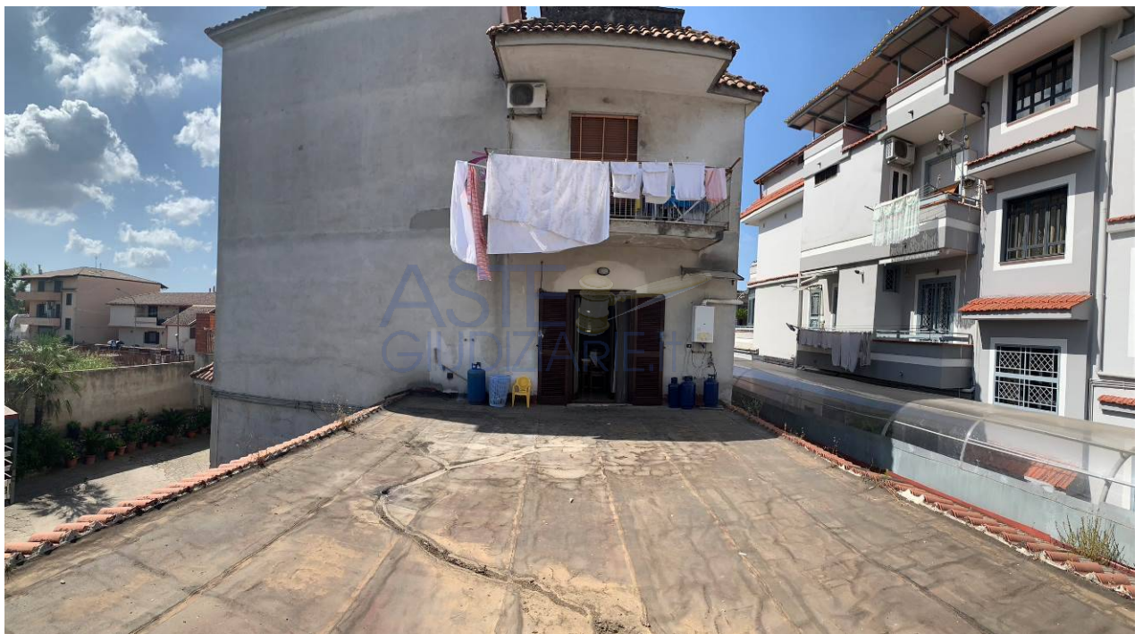
Foto 21 - B - Lastrico solare del sub 104 (non oggetto di esecuzione) su cui è prospiciente l'appartamento B
