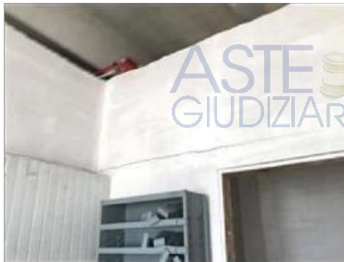
piano interno appartamento - vano interno fessurazioni
