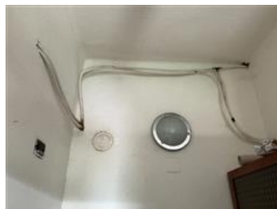
Parte dell'impianto di adduzione acqua "volante" nel cucinato
