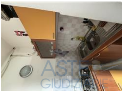
Cucinato, con vista di parte degli impianti di adduzione acqua "volanti"
