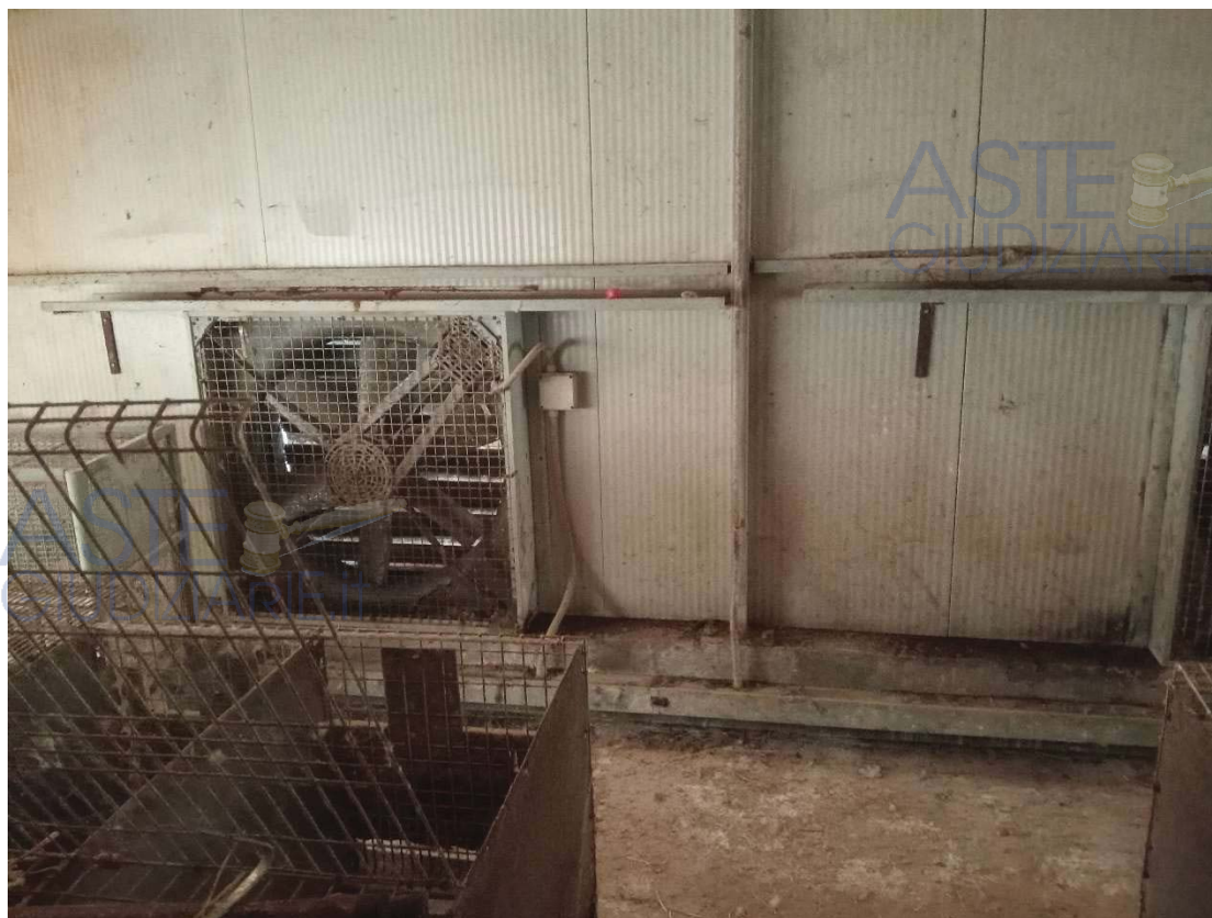
Foto 17, 18 e 19 Impianto di ventilazione
