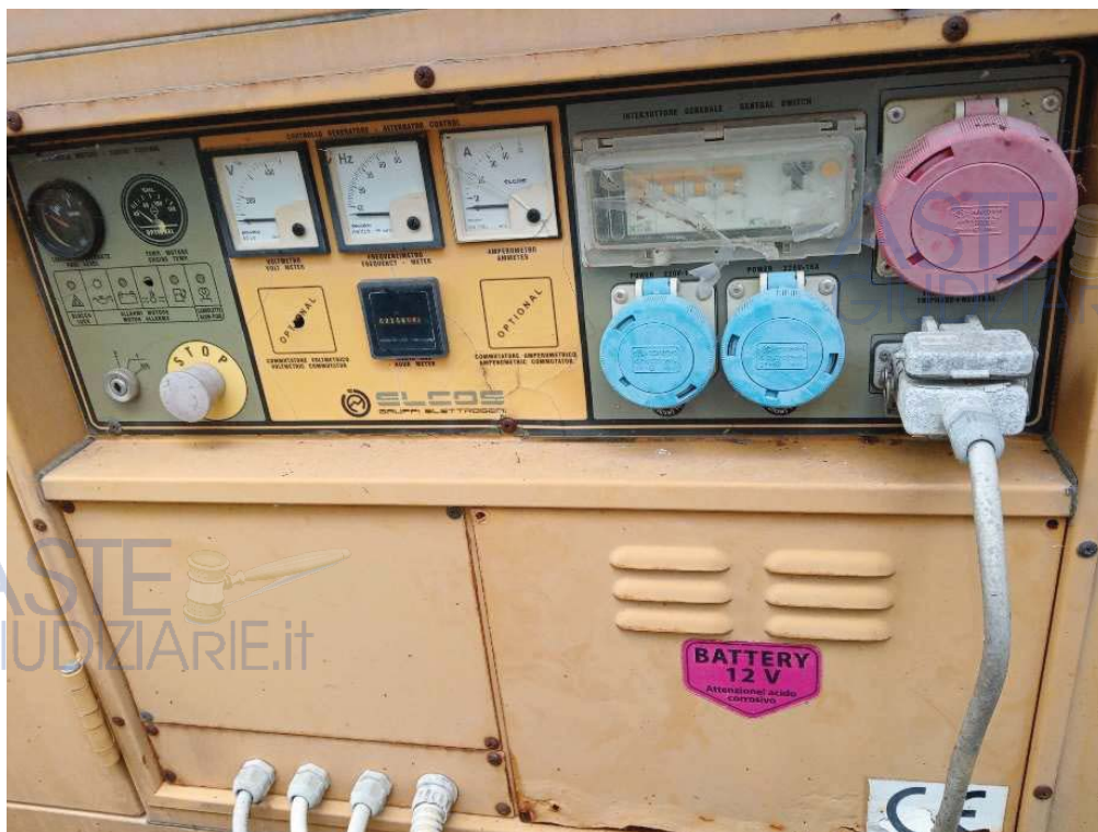
Foto 38 Pannello di controllo
