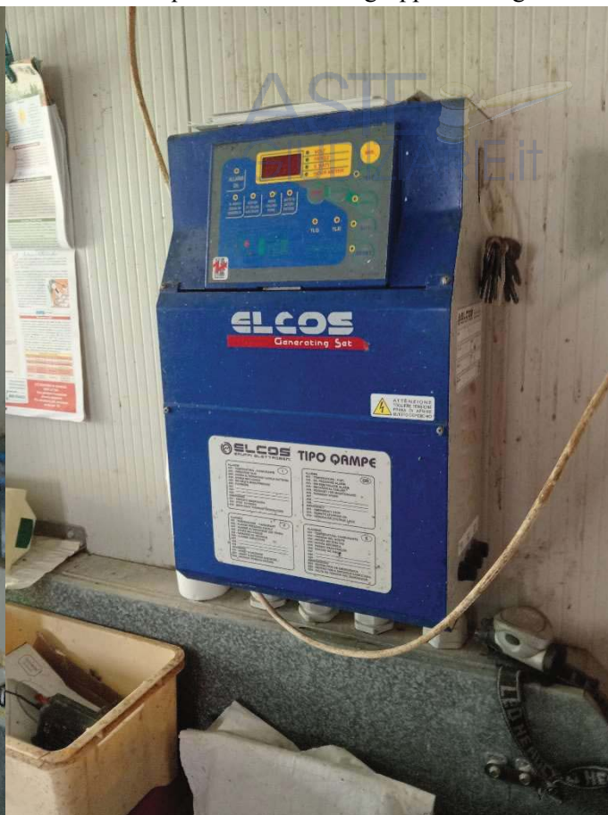
Foto 4 quadro di scambio gruppo elettrogeno
