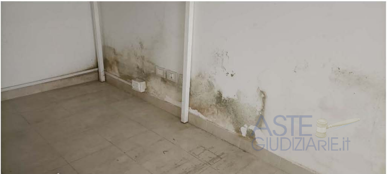
Umidità di risalita
