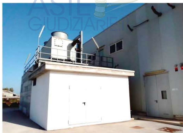
comparto della Centrale Biomassa - deposito e vasca
