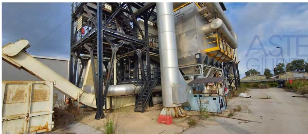
comparto della Centrale Biomassa
