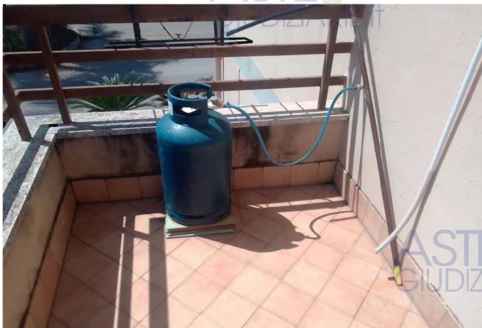
balcone lato Est - particolare impianto - bombola GPL
