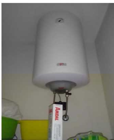
particolare impianto - boiler
