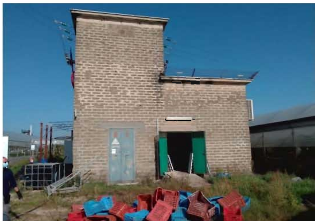
Vista frontale cabina enel
