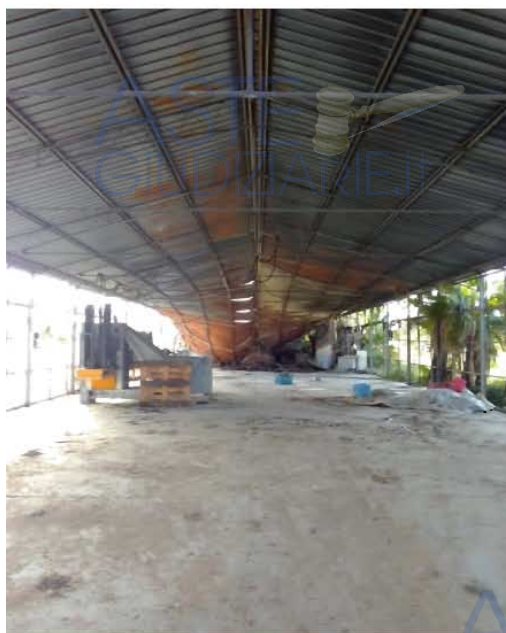
Serra agricola danneggiata da un incendio
