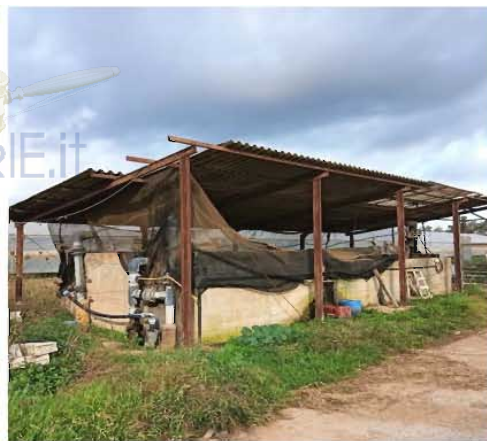
comparto della Centrale Biomassa - vasca
