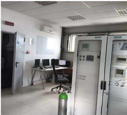
sala controllo al piano primo
