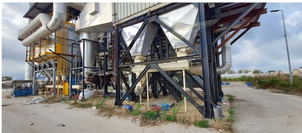
comparto della Centrale Biomassa
