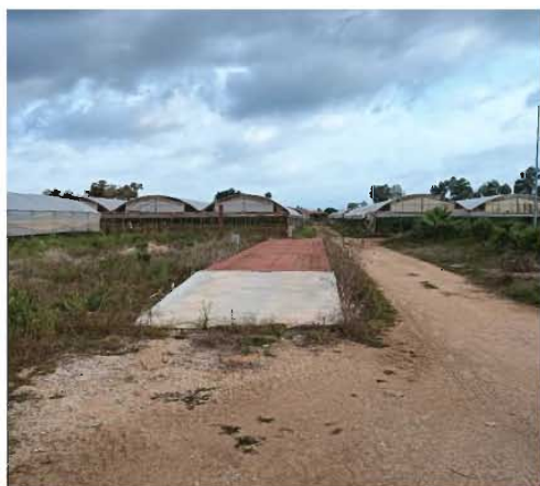
comparto della Centrale Biomassa - pesa
