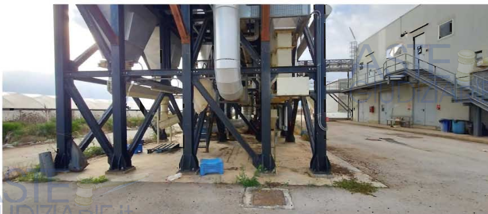
comparto della Centrale Biomassa
