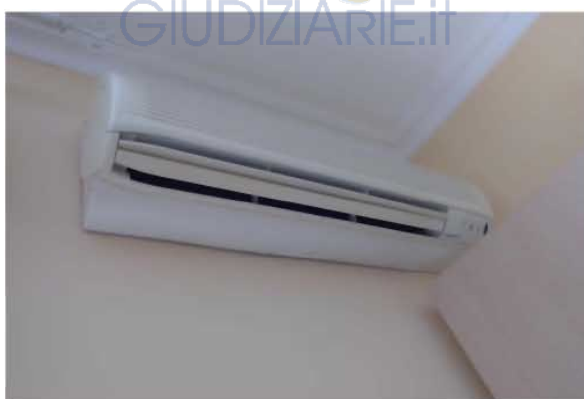
particolare impianto - condizionatore
