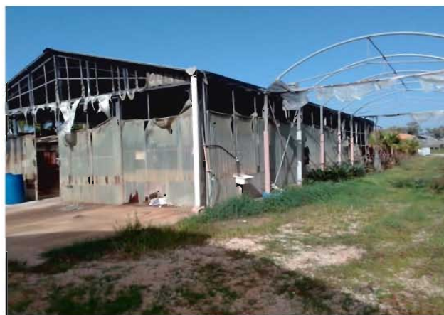
Serra agricola danneggiata da un incendio
