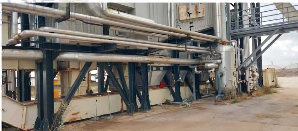
comparto della Centrale Biomassa
