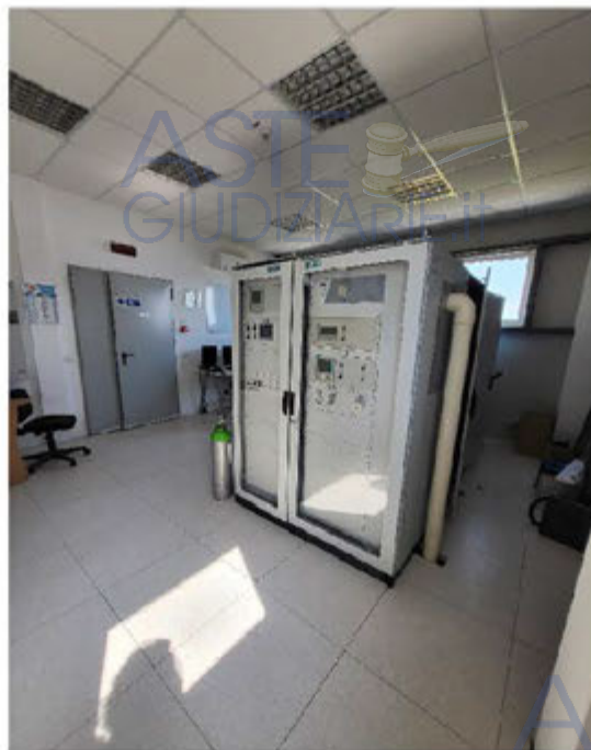
Foto 3: sala controllo piano primo
