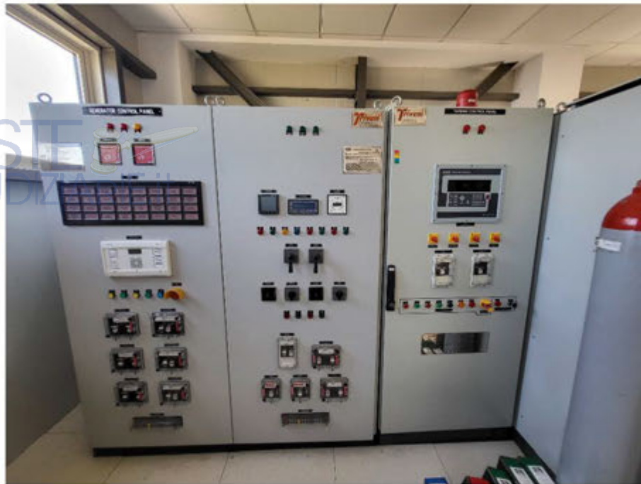
Foto 4: particolare sala controllo piano primo
