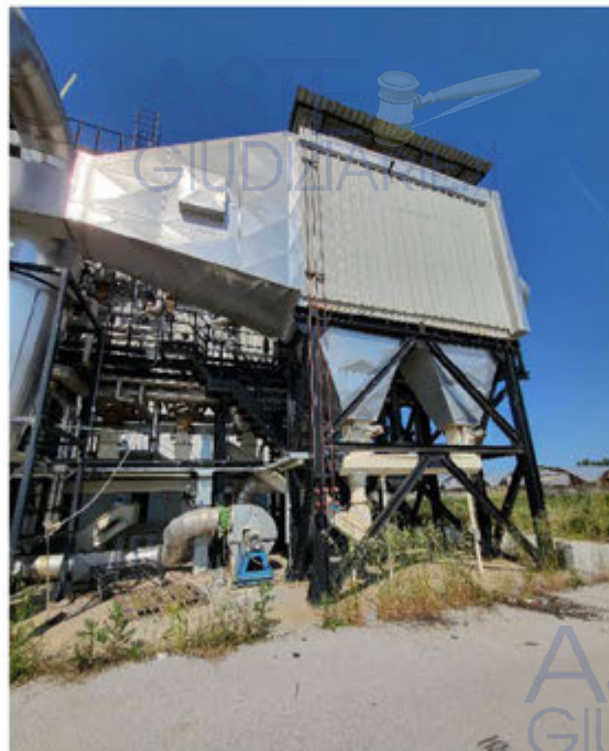
Foto 15: deposito ceneri secche (big-bags)
