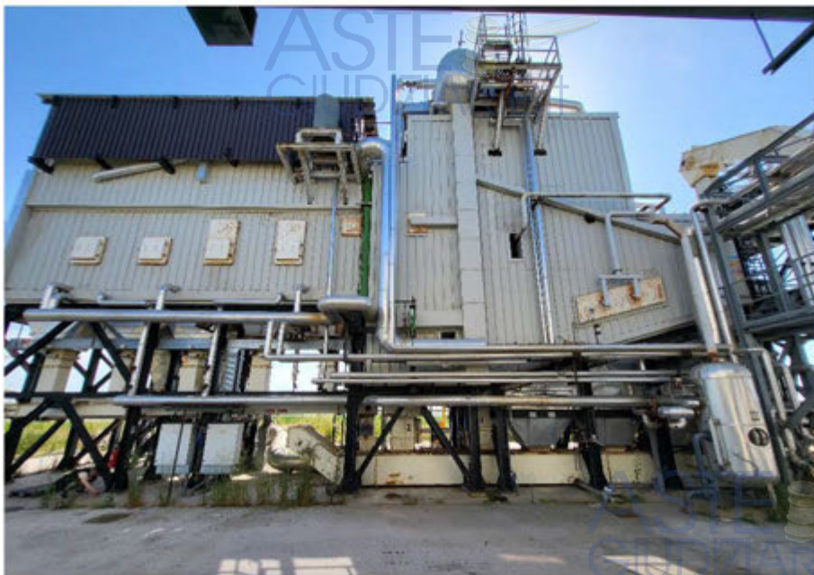
Foto 7: caldaia a biomassa
