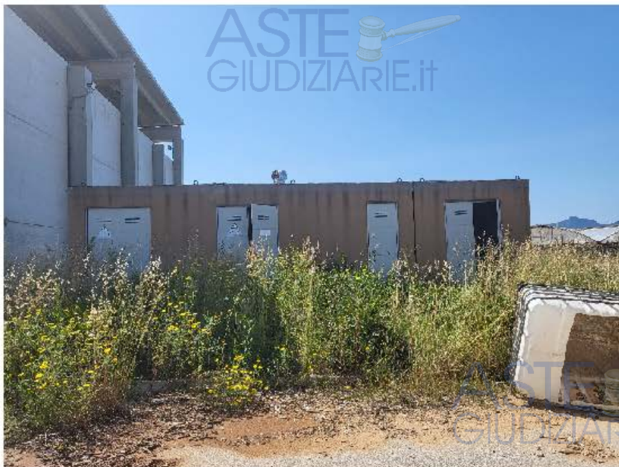
Foto 13: cabina connessione rete elettrica
