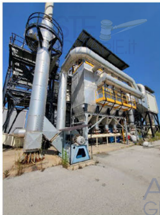
Foto 9: ventilatore estrazione fumi
