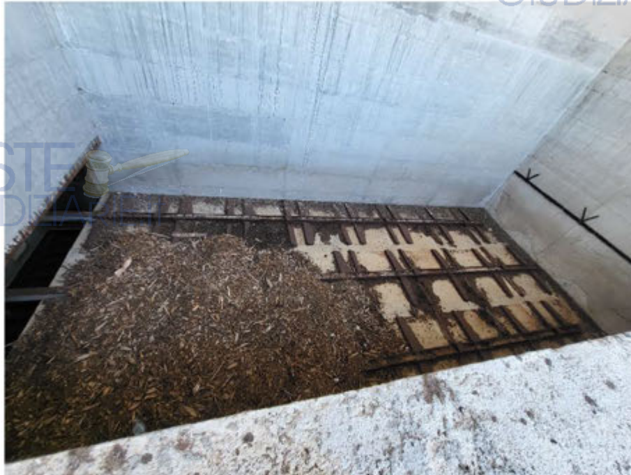
Foto 6: particolare sistema carico e scarico (moving floor)
